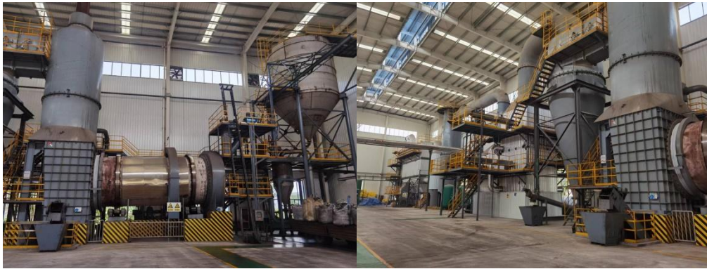
回转窑+二燃室-烟气净化设施
