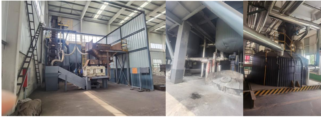
破碎-溶解釜-蒸馏釜
